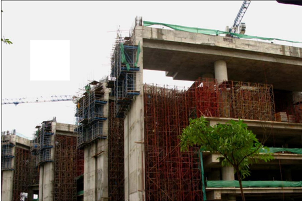
Thi công cốp pha tại dự án Dolphin Palaza, Từ Liêm, Hà Nội. Ảnh: Thanh Tuấn
